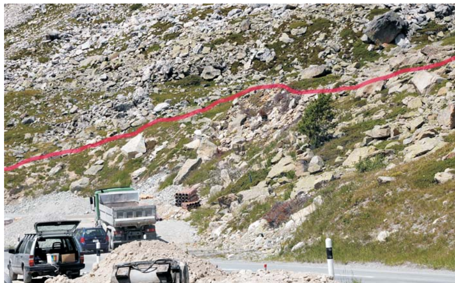
Mit Direktanlage von Bodenmaterial, Rasenziegeln und Blöcken weit zurückversetzte kaum erkennbare neue Böschung (unterhalb der roten Linie).
